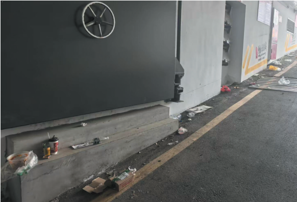
图为领秀翡翠湾小区地下车库乱丢垃圾未及时清理。
